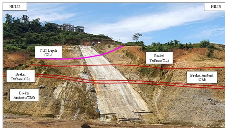
Gambar 4. Kondisi Fondasi Sandaran Kanan AS Bendungan
